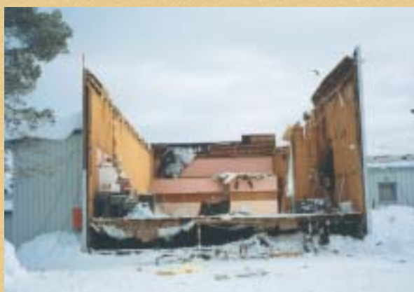
Tragická událost, při níž zahynuli příslušníci norské armády – zřícení střechy budovy, kde sídlil štáb norských cvičících jednotek, mezinárodní cvičení Adventure Express 2000, Norsko
