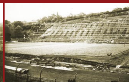
Stadion Juliska. Zemní úpravy pro západní tribunu. Foto: Konstruktiva, n. p. Praha, 1972
